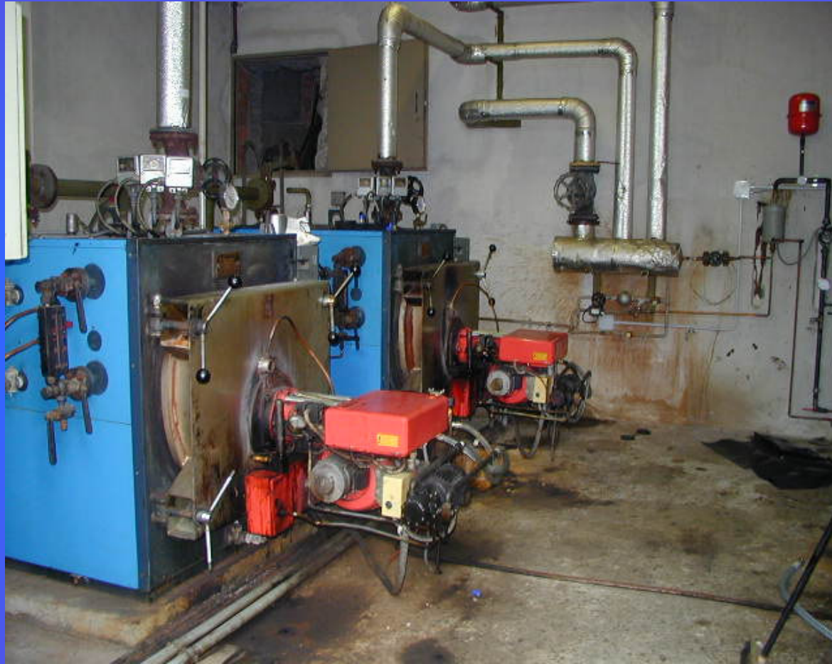
Caldaie a BTZ sostituite
