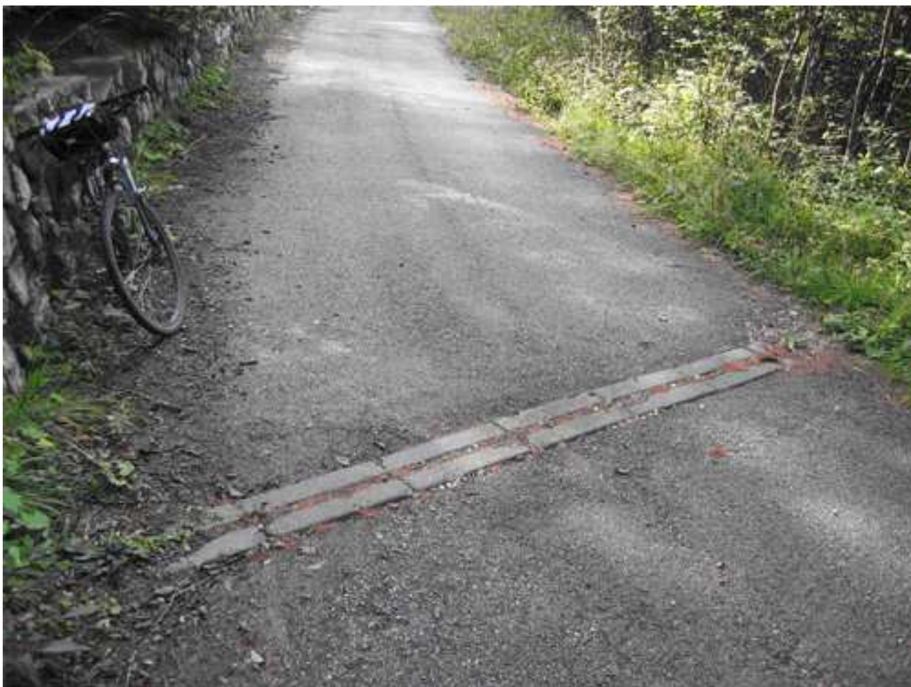
Fig. 12: canaletta di scolo delle acque meteoriche
